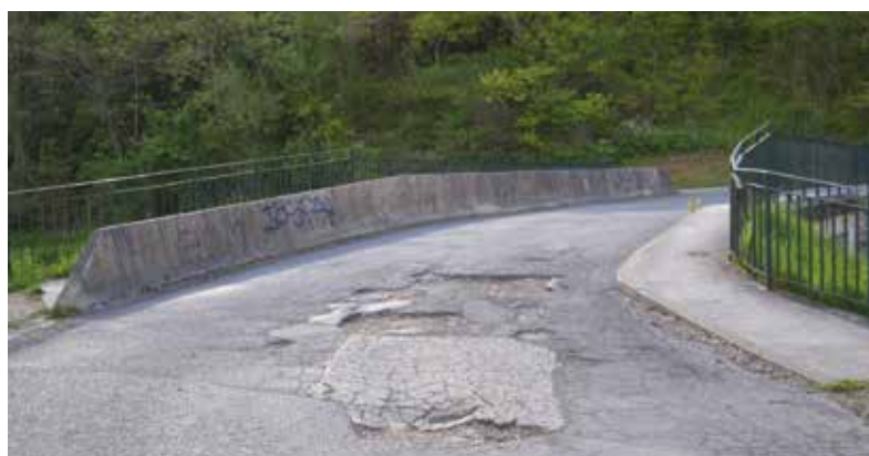
La rue de la Roche particulièrement dégradée
